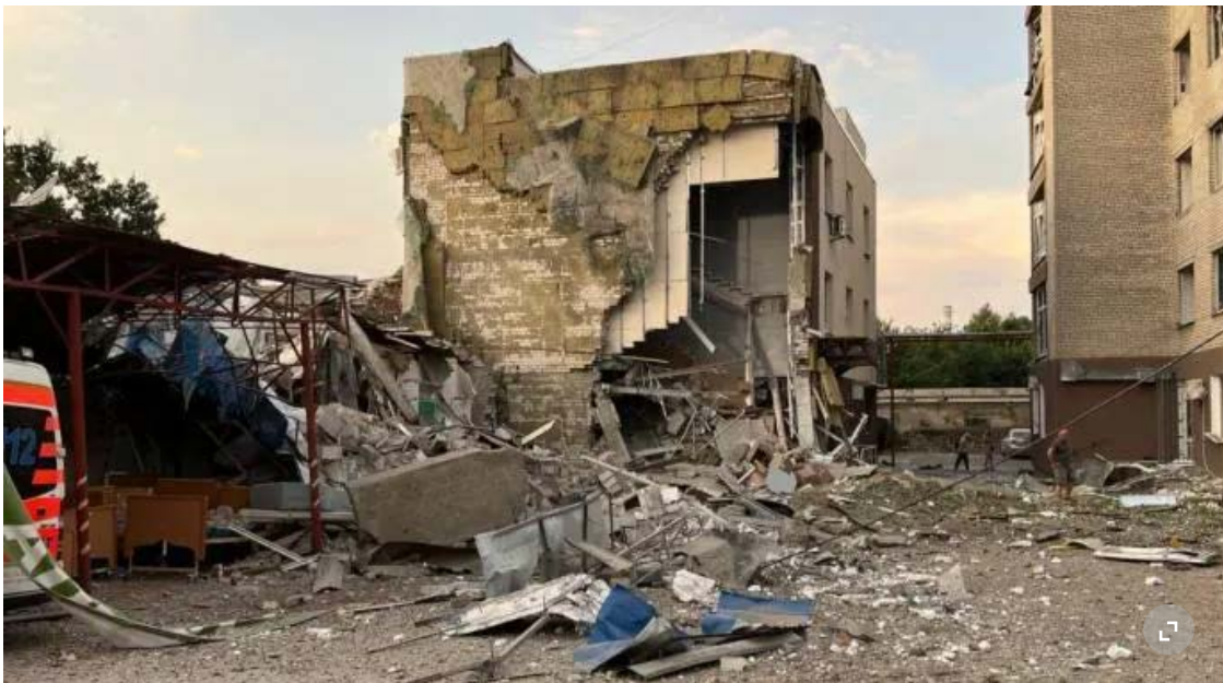
Das Rotkreuzspital in Mikolajiw wurde durch russischen Beschuss schwer beschädigt.
